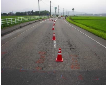
①ひび割れの状況
