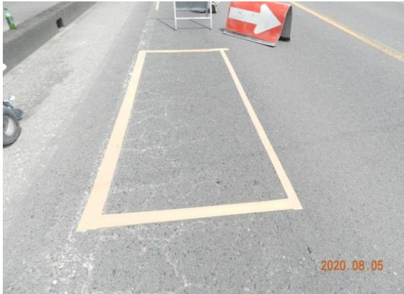
1) ひび割れの状況 令和2年8月5日施工
